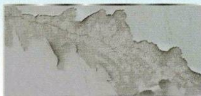
ฟิล์มสีลอกหลุด (Peeling)
