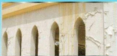
คราบเกลือหรือคราบขาวบนฟิล์มสี (Efflorescence)
